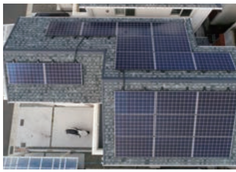
④ 日当たりのよい新居の屋根に設置された太陽光パネル
